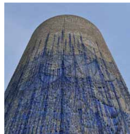
Výdech z tunelu Blanka ze segmentů z bílého betonu
