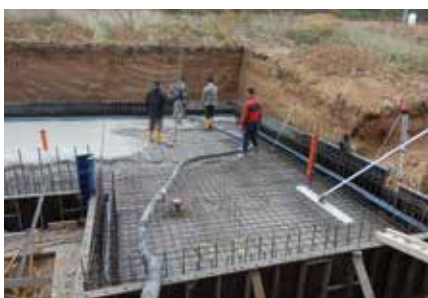
Betonáž desky Beton PERMACRETE se hutní běžnými prostředky (vibrátory). Intenzitu hutnění je nutné přizpůsobit objednané a dodané konzistenci. Povrch základové desky je možné leštit.
