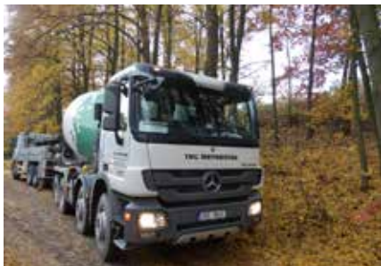
Doprava betonu na staveniště Doprava betonu na stavbu je zajištěna autodomíchávači. Směs není možné vyrábět v suchém stavu nebo v konzistenci pro převoz sklápěčkami.
