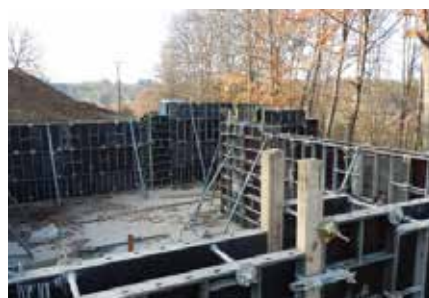
Vyztužení stěn bílé vany Stejně jako u desek je nutné vyztužit stěny navrhnout na maximální šířku trhliny při namáhání vnějším zatížením a vynuceným namáháním. U větších objektů jsou stěnové konstrukce vyztuženy klasickou tuhou vyztuží.
