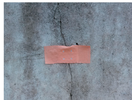
▲ Obr. 1. Vznik trhlin je třeba ve vodonepropustném betonu minimalizovat
