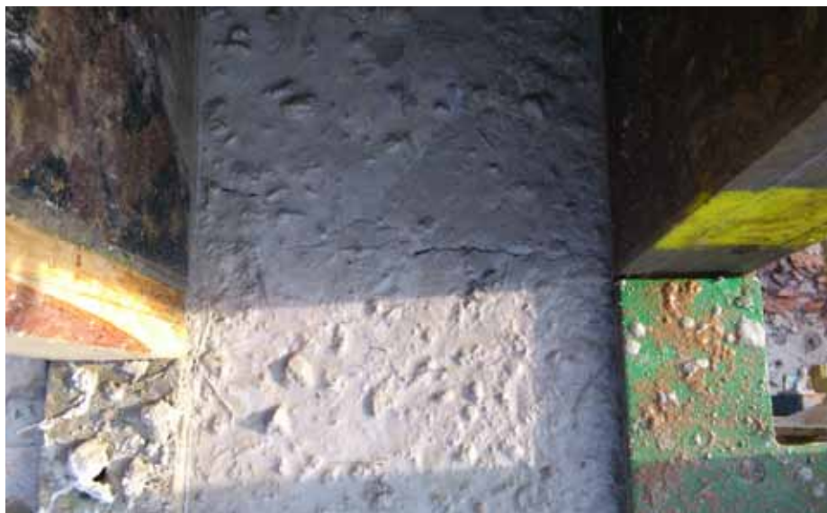
Obr. 1: Trhliny na povrchu stěny mimo bednění od plastického smrštění
